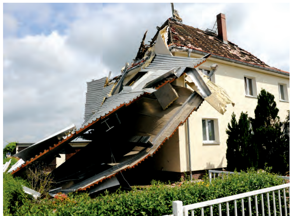
Zahlreiche Häuser wurden durch den Tornado erheblich zerstört. Foto: Brühl
